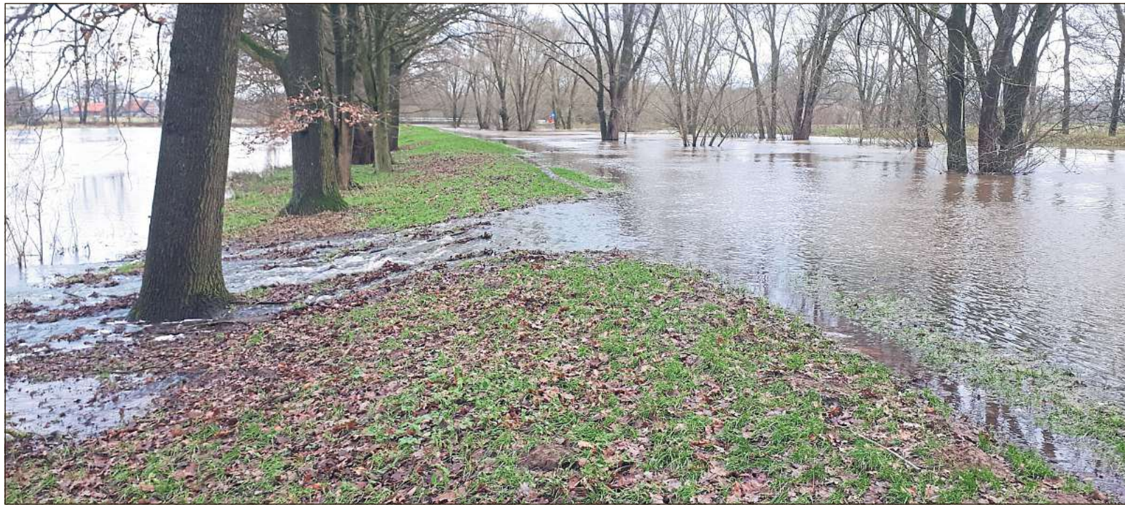
In den vergangenen knapp 30 Jahren sind die Deiche an der Glenne nach Ansicht der Wadersloher Initiative Zin 19 vernachlässigt worden. Bei der Hochwasserlage über Weihnachten ließen sie Wasser durch. Foto: Schulze Waltrup
